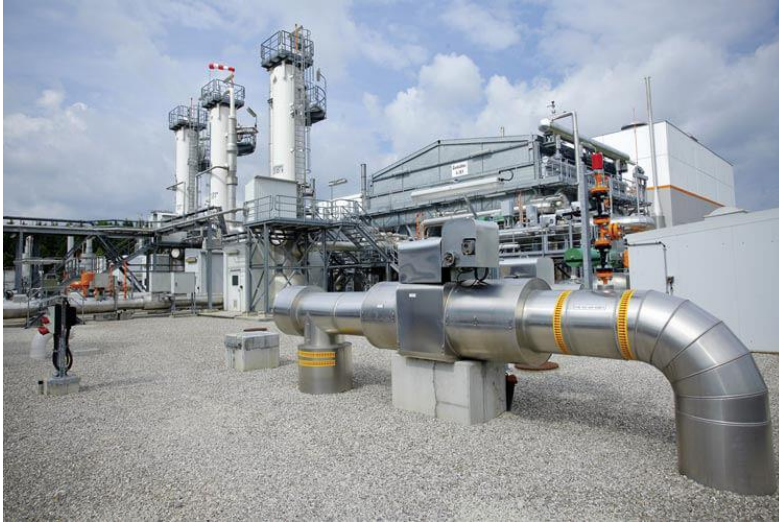
Erdgasspeicher der RAG Energy Storage GmbH
