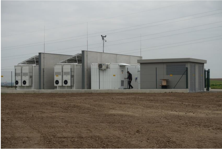
Batteriecontainer, Steuercontainer, Trafostation
