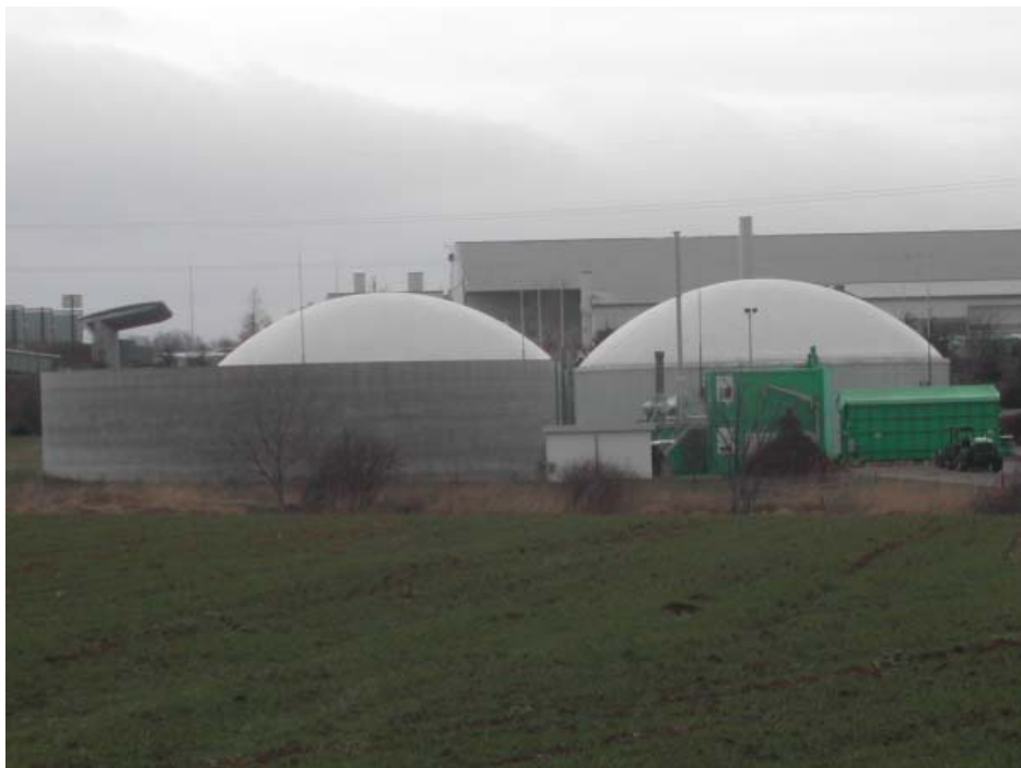
Foto: BEB Bioenergie AG
