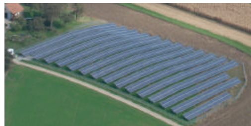
Photovoltaik-Kraftwerk Leitenfeld Gemeinde Haidershofen Größe: 550 kW Inbetriebnahme: Juli 2012
