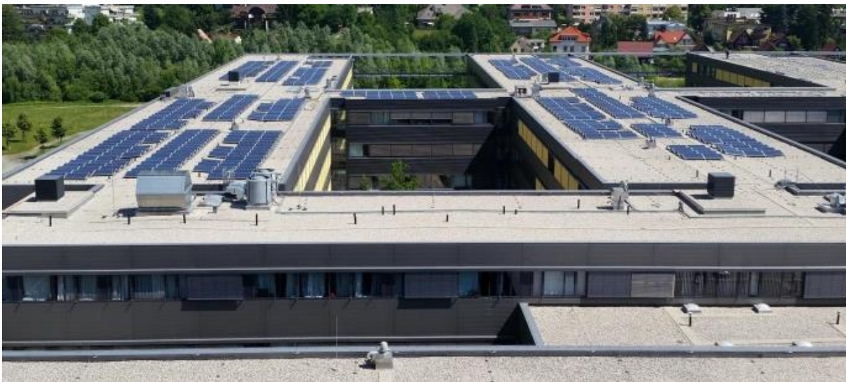
Blick auf den „Generator 1“
