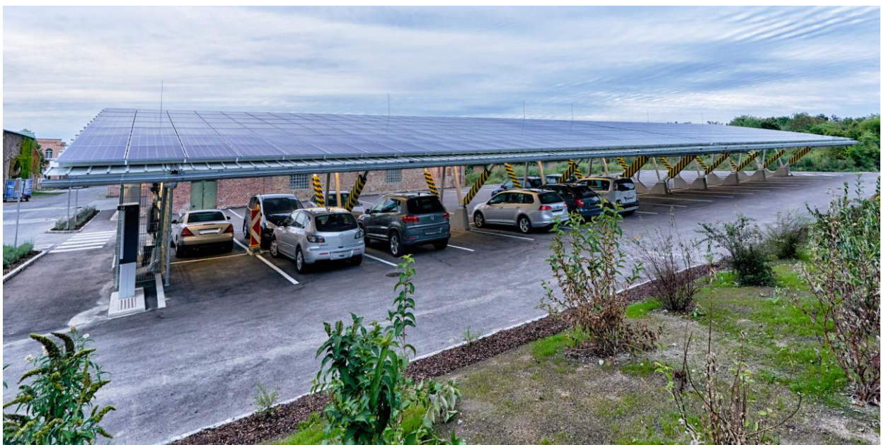
Carport mit Photovoltaikanlage, Parkplatz 2
