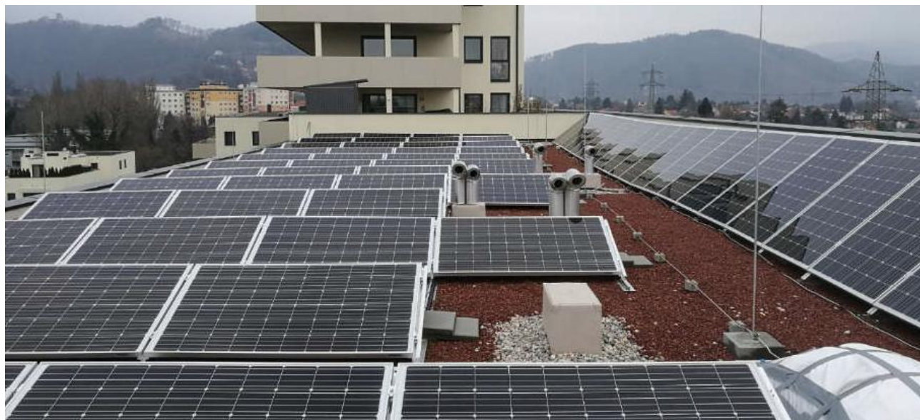
Die fertiggestellte PV-Anlage im Wohnpark Gösting
