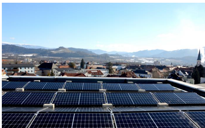
Teile der PV-Anlage auf dem Dach des Krankenhauses der Barmherzigen Brüder in St. Veit/Glan
