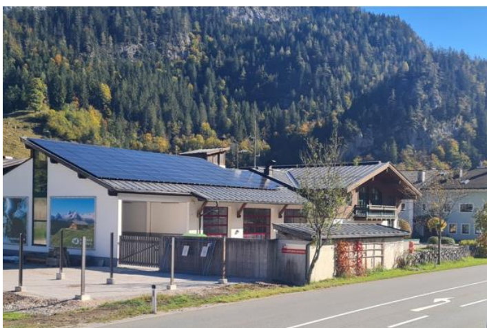
PV-Anlage 2 Feuerwehr / Bauhof
