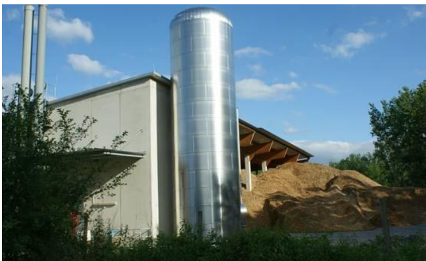
Pufferspeicher, im Hintergrund das Heizwerk mit Hackgut
