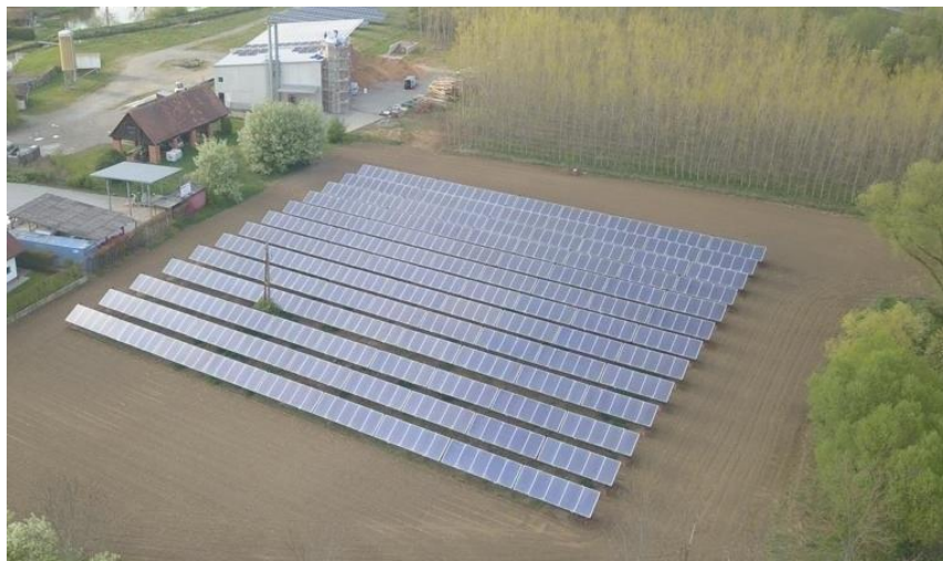
Thermische Solaranlage in unmittelbarer Nähe des Heizwerks
