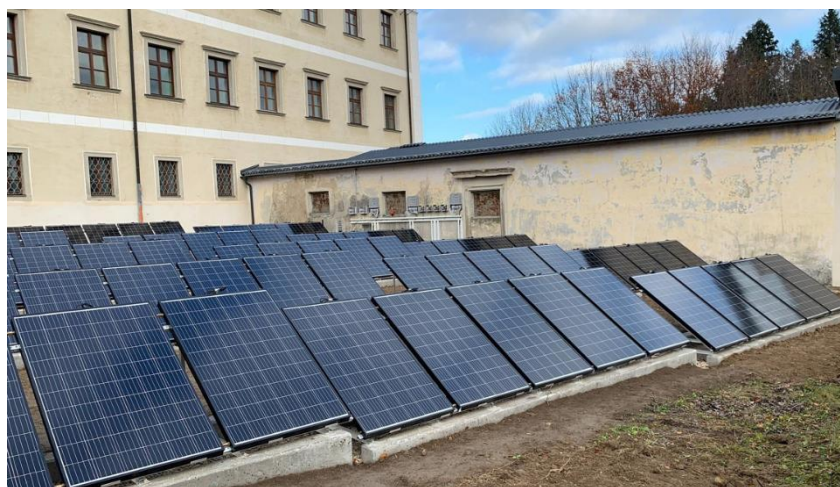
Abb. 1: Ansicht der am Nebengebäude aufgestellten PVT-Kollektoren (Quelle: BES)
