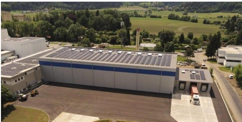
PV-Anlagen Werk Klagenfurt
